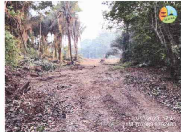
Foto 08: Construção de aceiro para evitar alastro de fogo próximo a comunidade "Centrinho".
